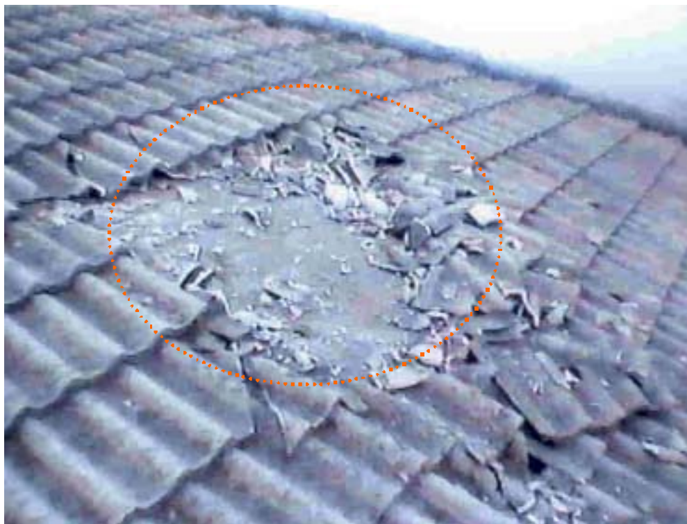
Danni al cornicione e tetto della abitazione toccata appena dalla semiala e carrello sinistro
