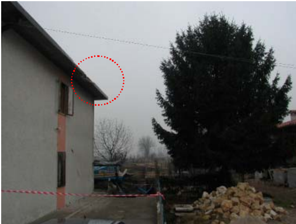
Punto di impatto. Notare il danno al cornicione dell'abitazione
