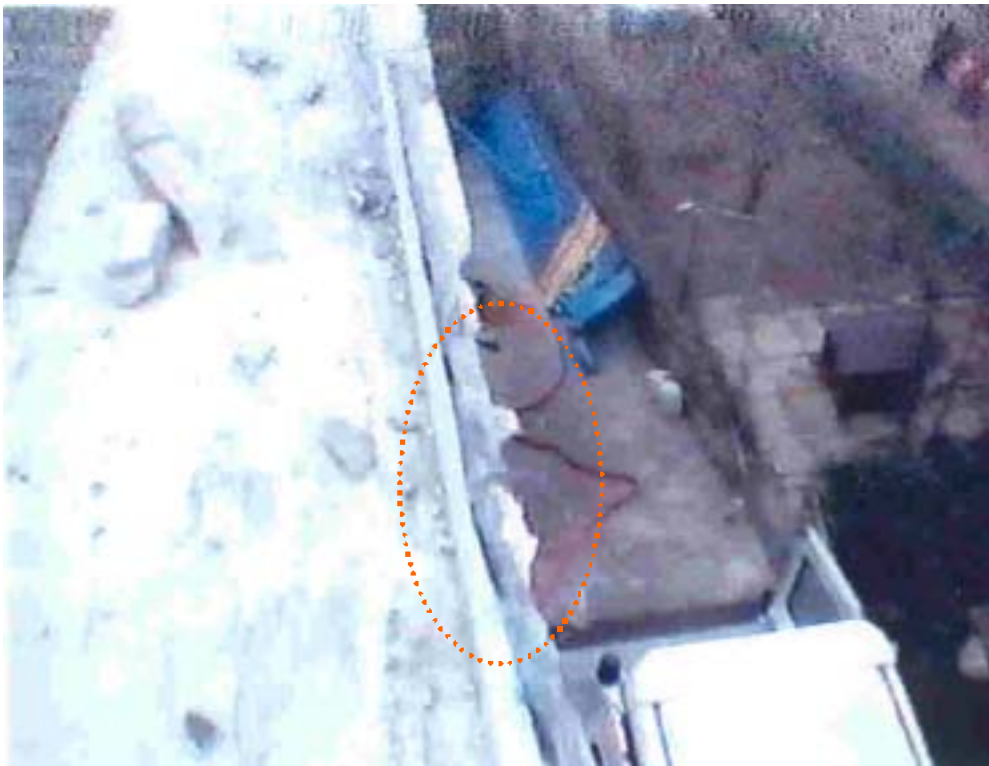
Danni al cornicione e tetto della abitazione toccata appena dalla semiala e carrello sinistro
