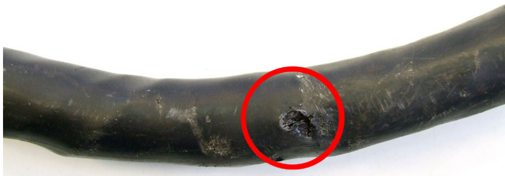
19. ábra: a meghibásodott kábel külső felületén látható égésnyom
