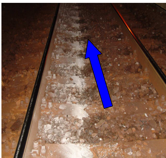
4. ábra: A sérült betonlajak
