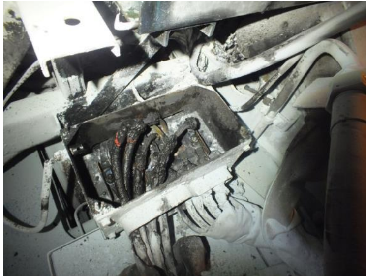
8. ábra: A rongálódott bekötődoboz a megégett kábelezéssel
