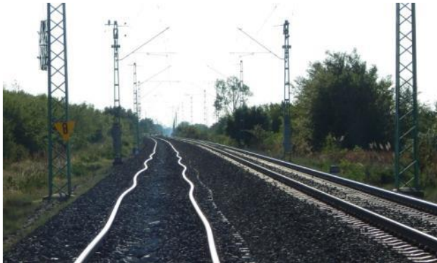
2. ábra: a megrongálódott vasúti pálya a megállás helyétől visszafelé nézve
