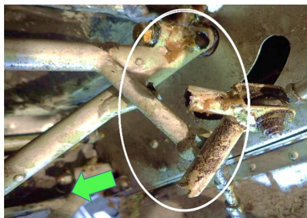
6. ábra: A jobboldali rudazathoz csatlakozó letört csonk
