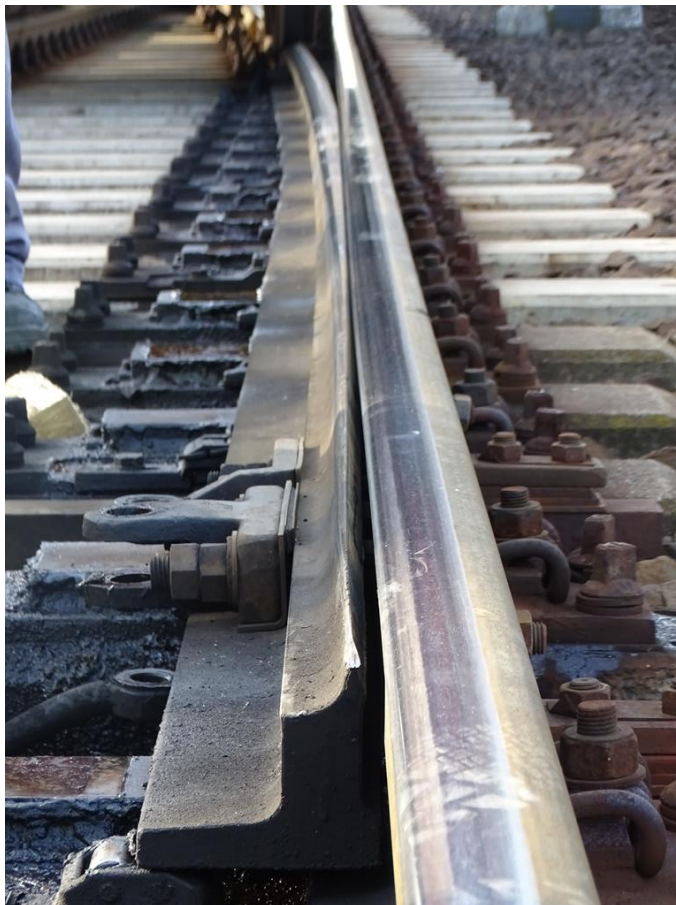
2. ábra: a váltófelvágás következtében torzult csúcssín
