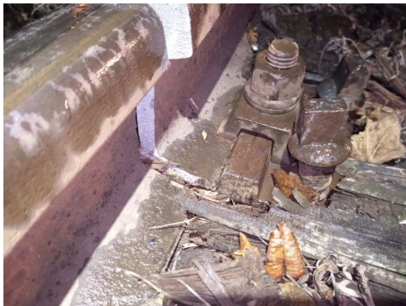
4. ábra: a 30. alj (benyomódott alátétlemez a kiszakadt csavarral)
