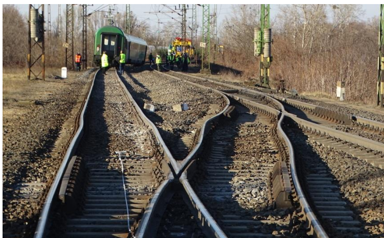
6. ábra: a megrongálódott vasúti pálya a kisiklás helyén
