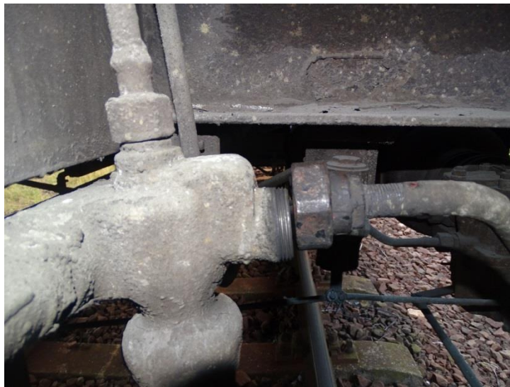
5. ábra A megnyílt fővezeték
