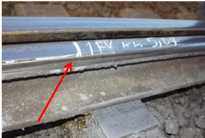
4. ábra: első forgóváz felkapási nyoma az íves csúcscsín
