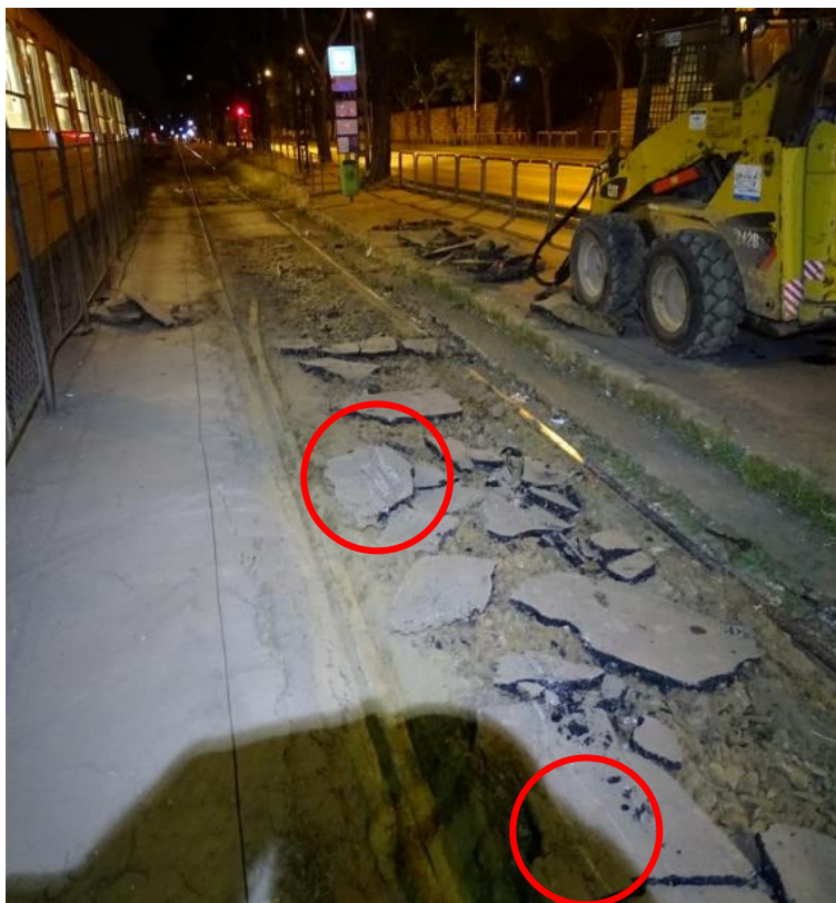
4. ábra: a feltört aszfalt a villamos elvontatása után, karcolásnyomokkal
