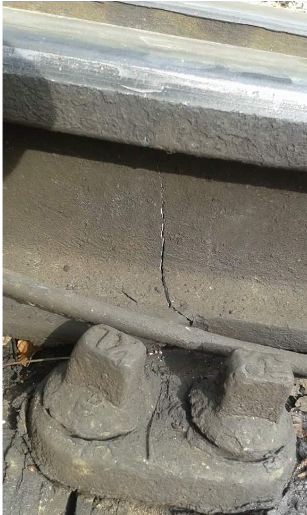
14. ábra: a helyreállításakor eltört csúcssín (fotó: MÁV Zrt.)
