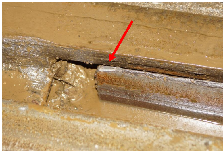
6. ábra: az íves csúcssín megnyílvá, a hegyén ütésnyom látható
