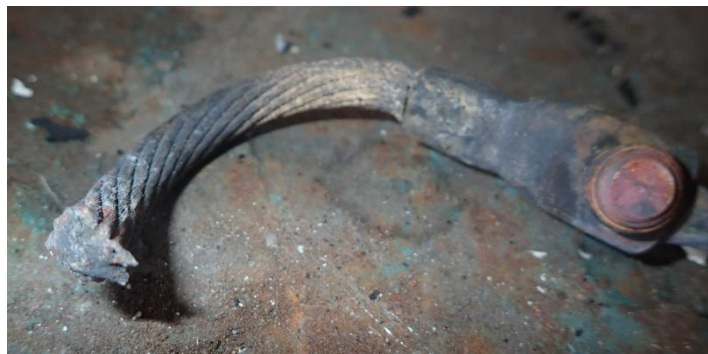
3. ábra: az átvezetésnél megolvadt kábel
