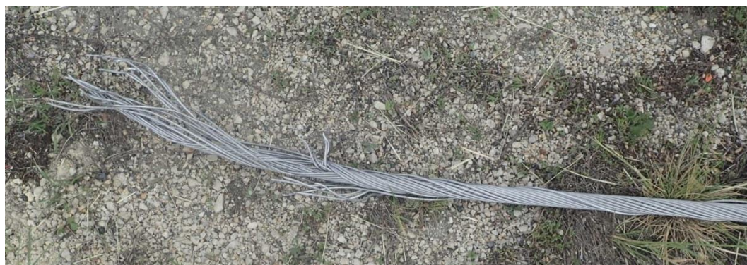
12. ábra: az elszakadt 25 kV-os kábelsodrony
