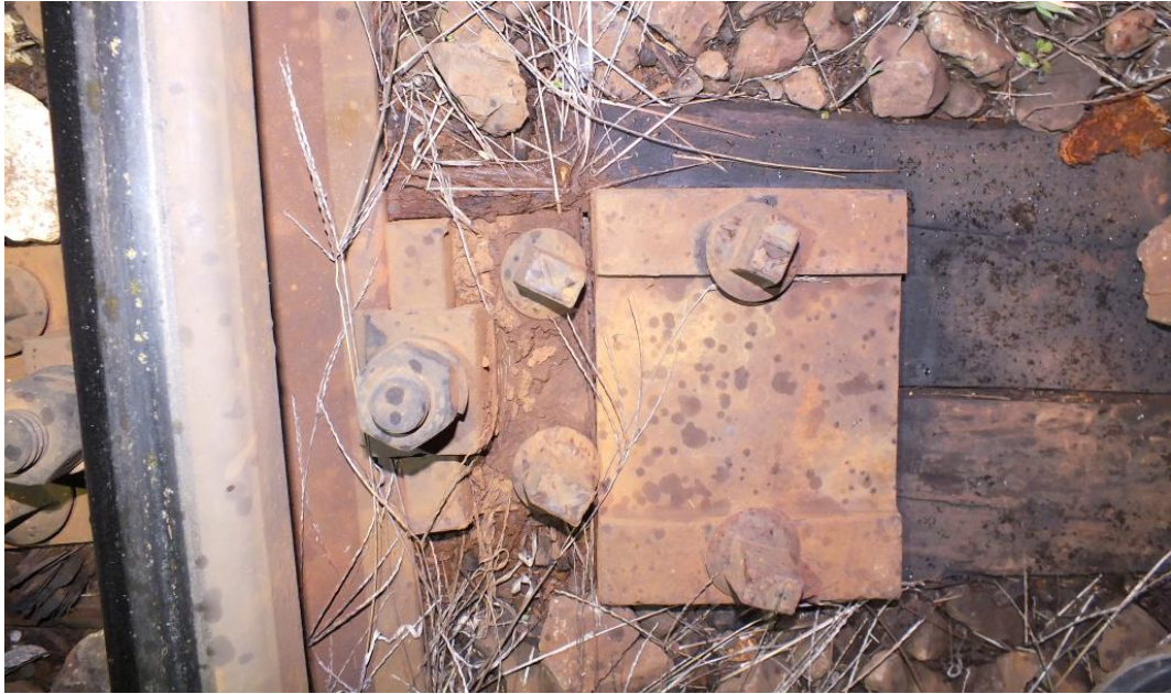
4. ábra: megtámasztott leerősítés és oldalra tolódás nyoma (Kelebia)
