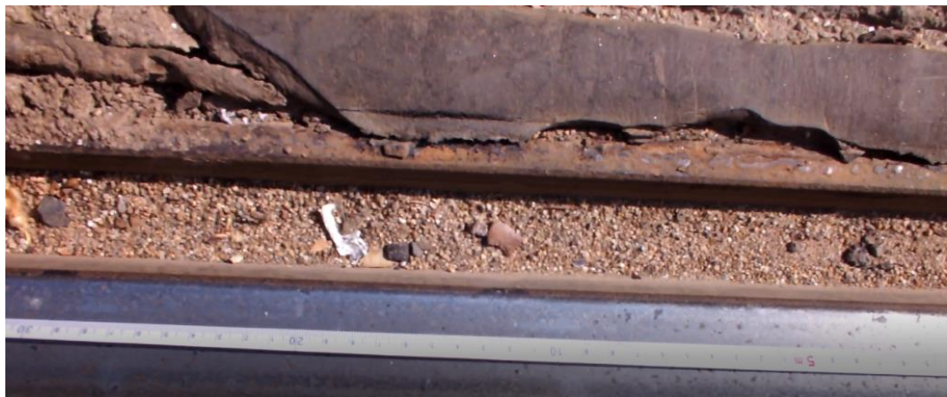
8. ábra: a bal sínszál tömítésének rongálódása (a mérőszalag 2 m-es beosztása van a nullponton)
