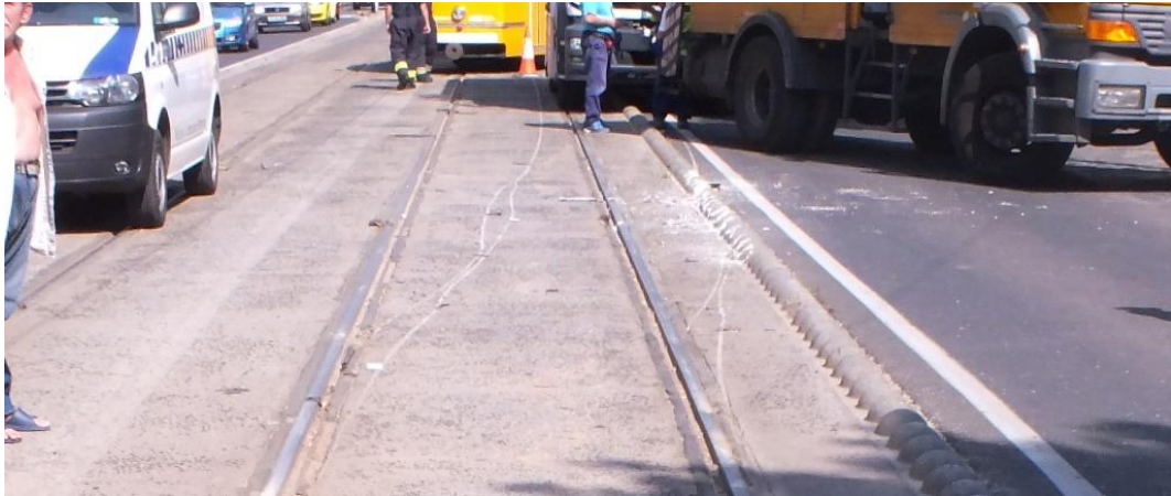
4. ábra: a gömbsüvegsor sérülése
