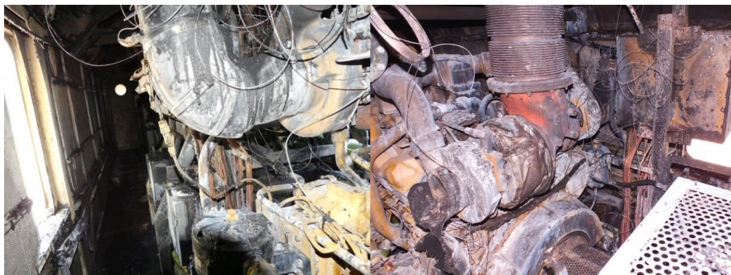
6. ábra: égésnyomok a turbófeltöltők környezetében
