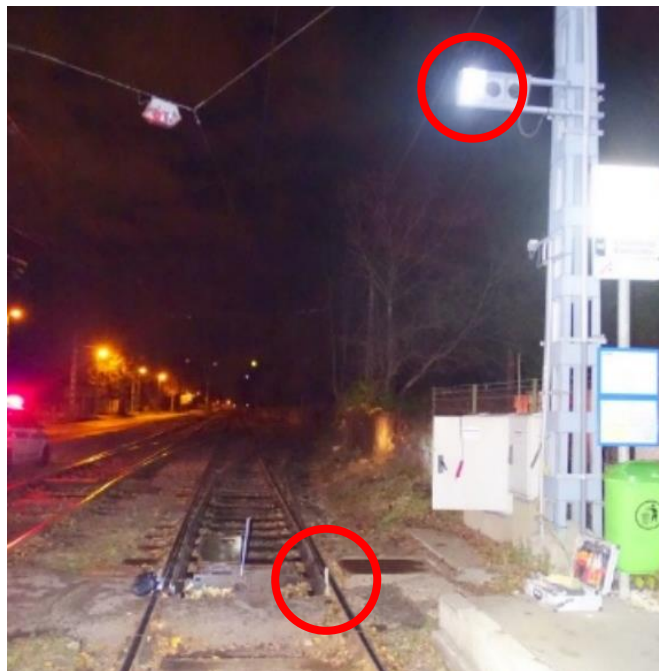
18. ábra: a váltójelző akadályozott állításánál
