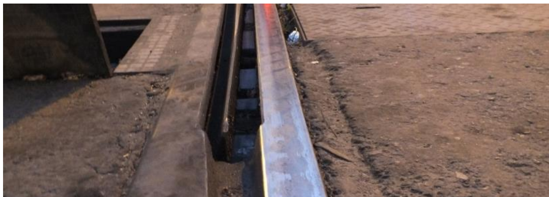
15. ábra: A megnyílt, és a kerék által is megütött csúcssín
