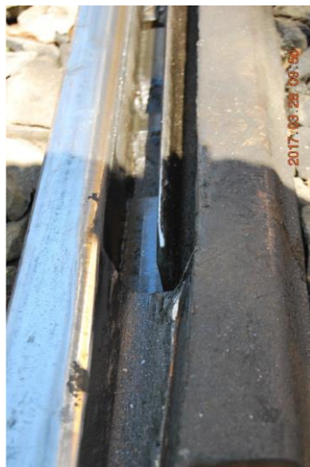
6. ábra: Ütésnyom a bal oldali csúcssínen (forrás: BKV Zrt.)
