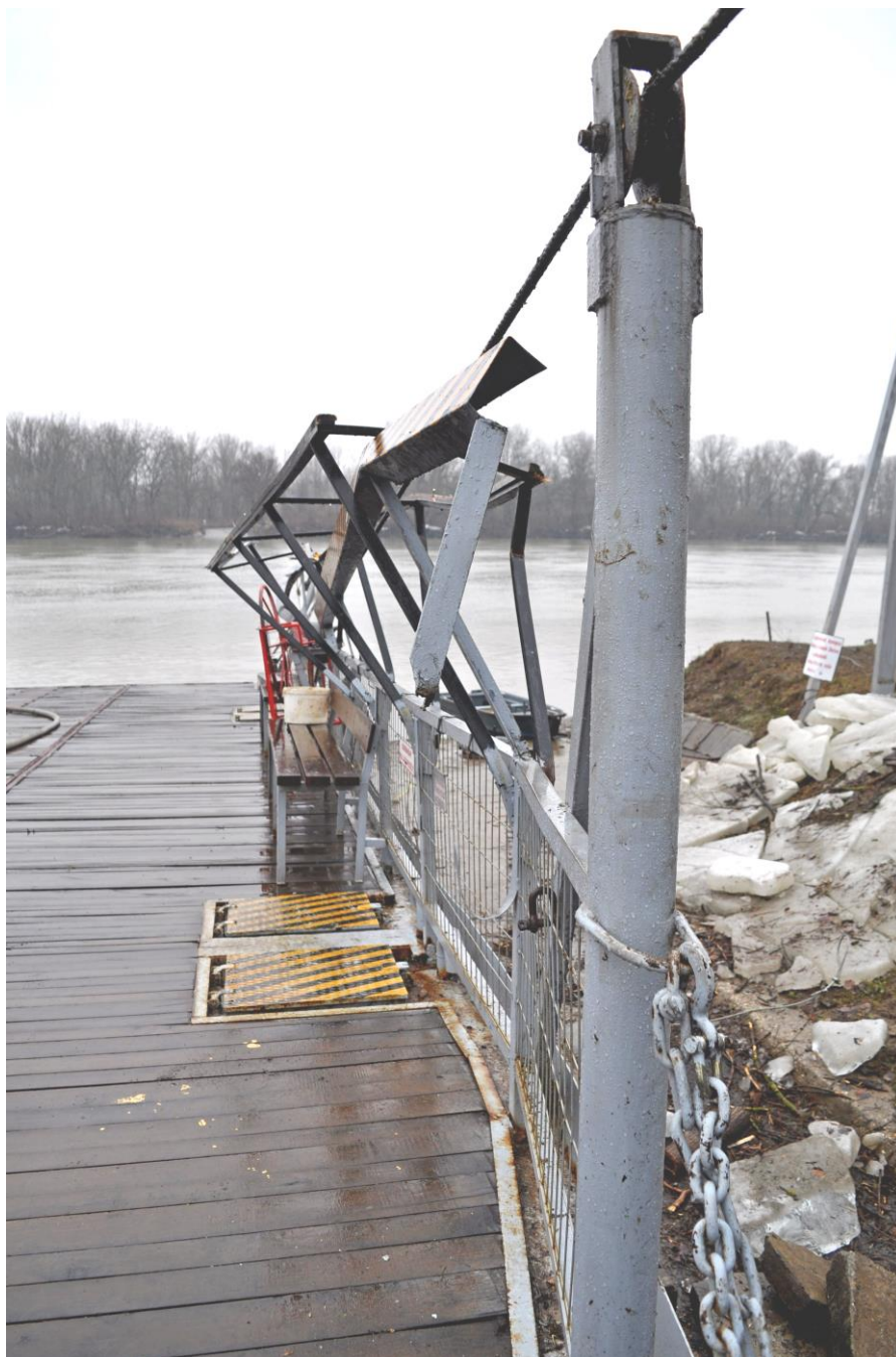
10. ábra: A sérült korlátok Fotó: Üzemeltető
