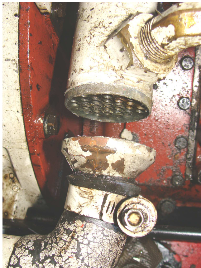
13. ábra: A hőcserélő testről leszakadt fedél
