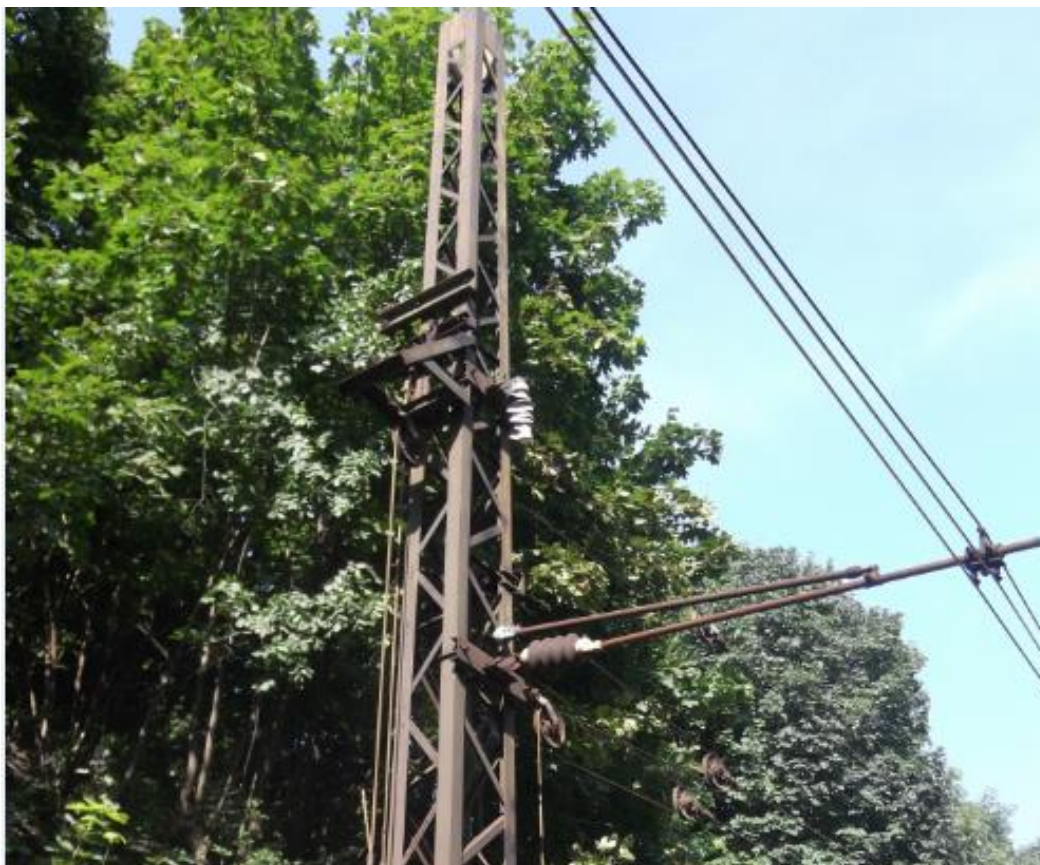
9. ábra: a villamos felsővezeték üzemét veszélyeztető növényzet
