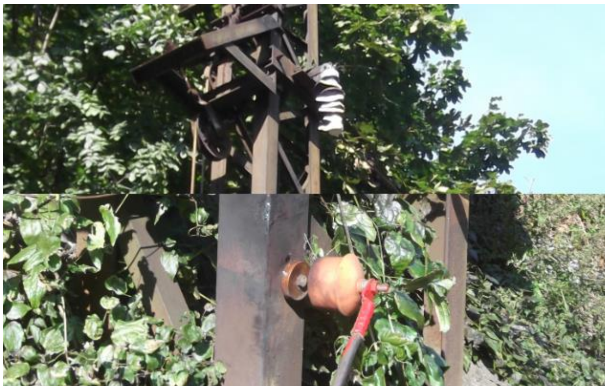
6. ábra: a megrongálódott szigetelő és szikraköz
