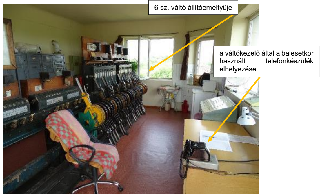
9. ábra: II. állítóközpont belső elrendezése
