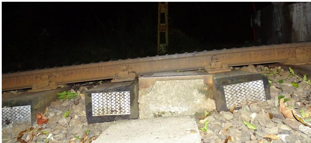
27. ábra: egy megtámasztó betontömb jelen állapotában
