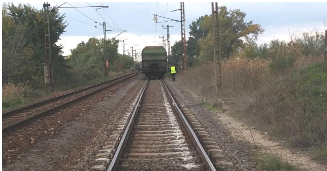
5. ábra: A kisiklott kocsi által megrongált vasbetonaljak.
