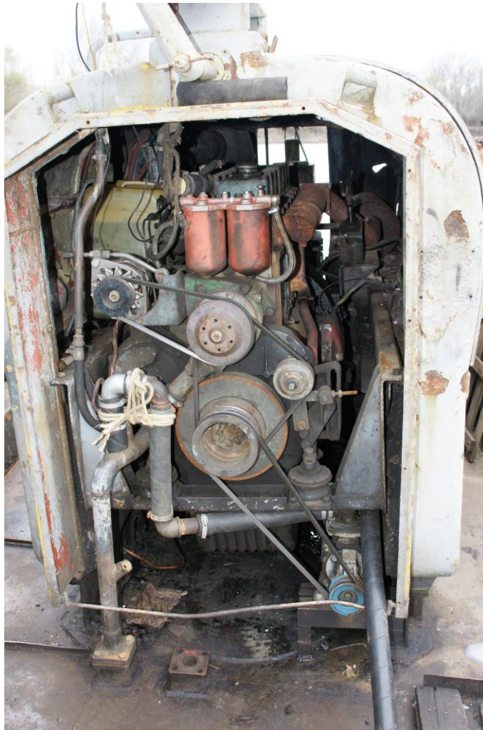
6. sz. kép: A hiányzó burkolat és a hűtővíz csőrendszer egy része
