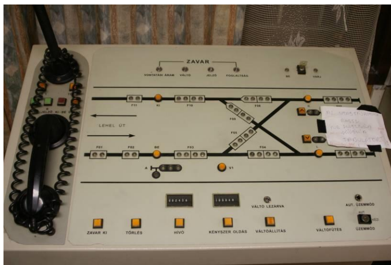
4. ábra: A Lehel téri végállomás jelzőberendezése
