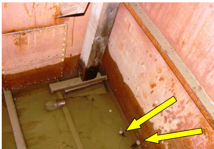
5. kép: Egy elbálázott szivárgás, a hátsó lakóteri válaszfalnál, és két db betonvas által átszúrt lyuk a hajófenéken, amit eldugóztak kiemelés után
