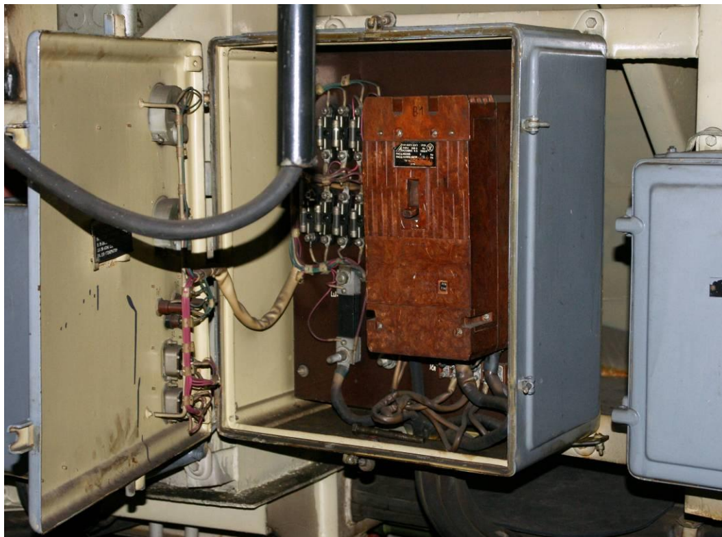
11. sz. kép: A meghibásodott berendezés a helyén
