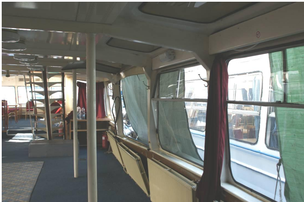
8. sz. kép: A Hullám ms sérülése belülről
