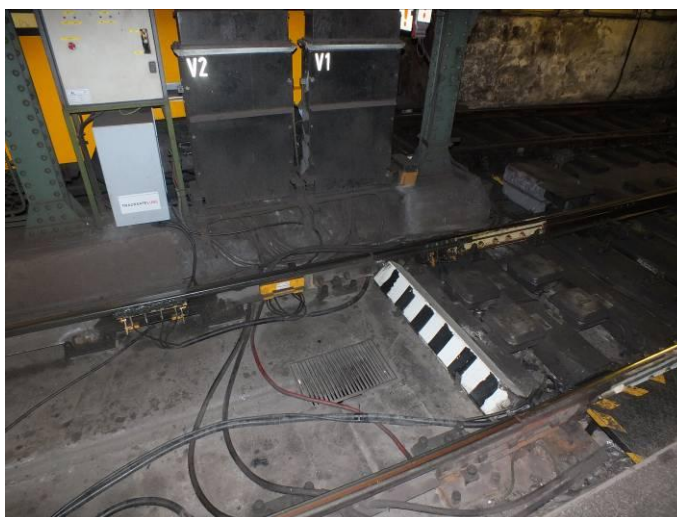
7. ábra: A telepített kenőberendezés
