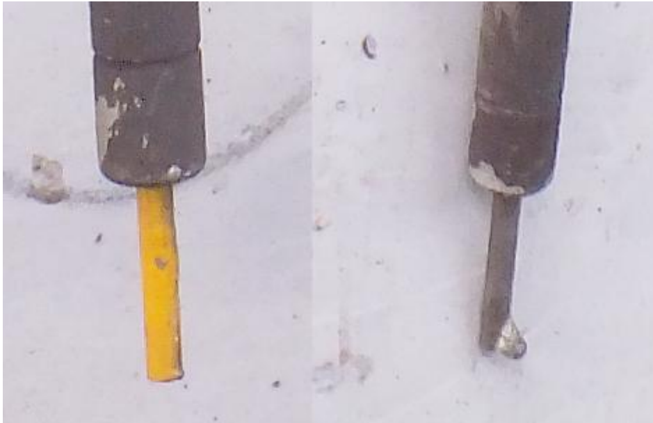
13. ábra: A néhány nappal korábban cserélt olvadóbetétek. (A 2/3-os részből származó a jobb oldalon)
