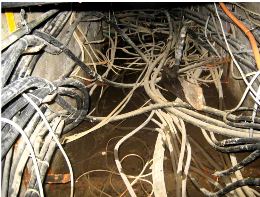
10. ábra Alagsor kábelcsatornájának képe (a vizsgált esemény idején)
