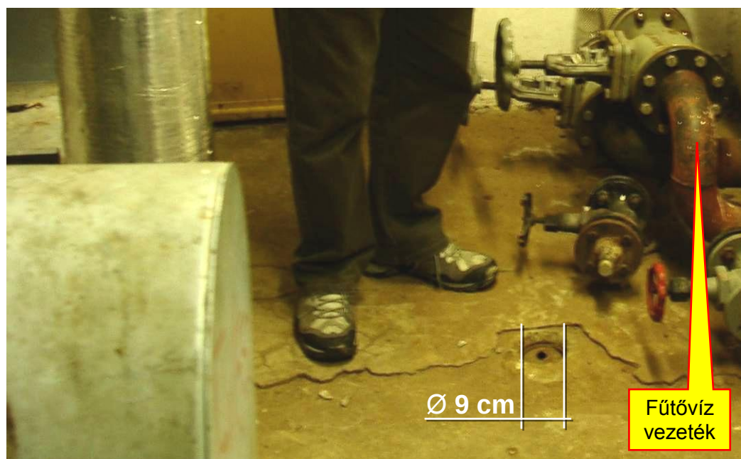
12. ábra Szellőzőgépházba beépített Suez típusú padló összefolyó
