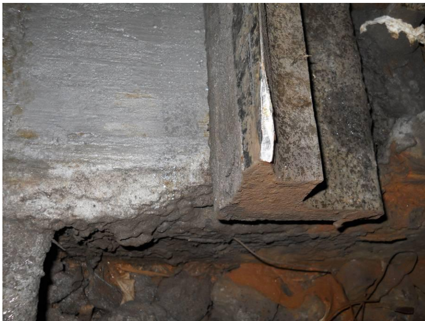
4.sz.ábra:a 7 sz. váltó csúcspén hegyén a friss ütésnyom
