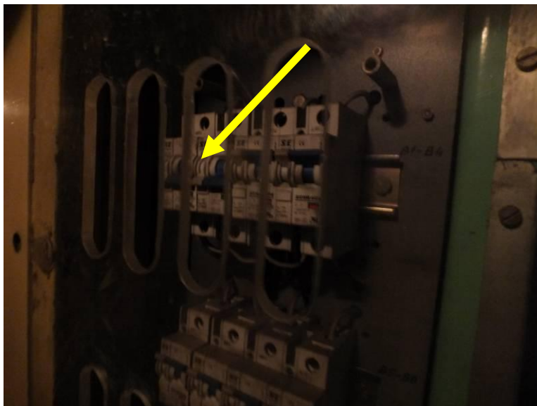
7. ábra A kikapcsolt kismegszakítók
