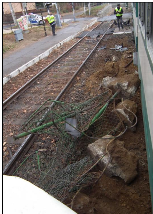
4. ábra A megrongált kerítés
