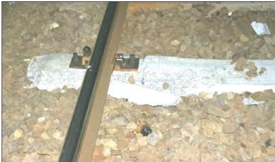
5. ábra: Megsérült vasbetonalj a siklás helyszínén
