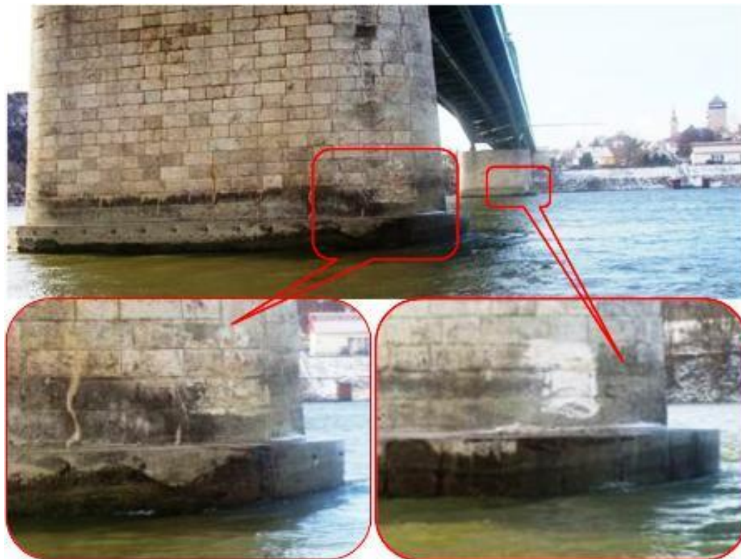
10. számú ábra a hídpilléren keletkezett sérülések
