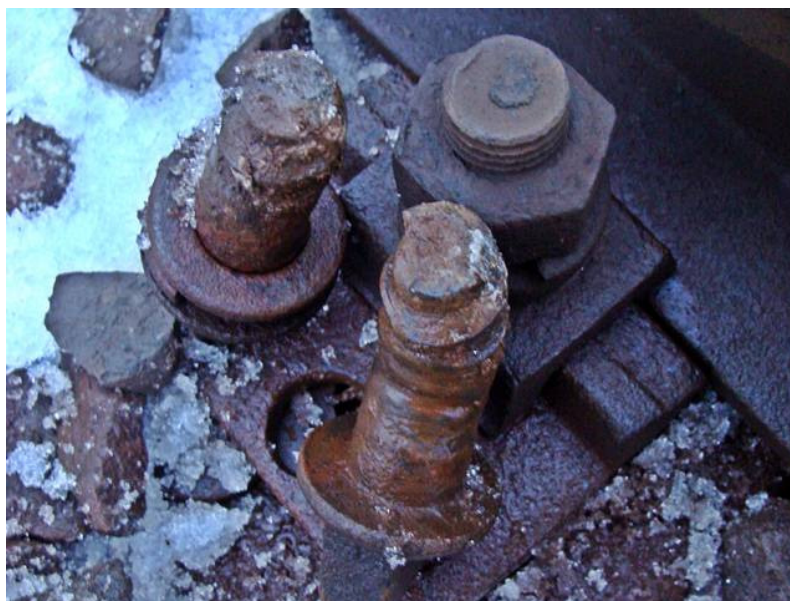
9. ábra: Törött sínscavarok az eset helyszínén
